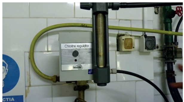
Figura 8. Instalație de clorurare a apei
